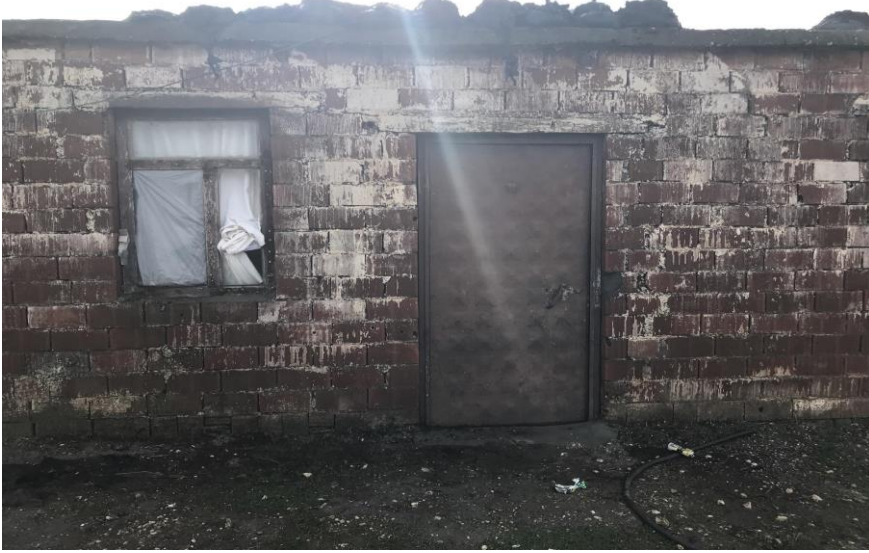
Çakirtutmaz köyünde arama sırasında zarar görmüş bir evin bir dış görünümü
